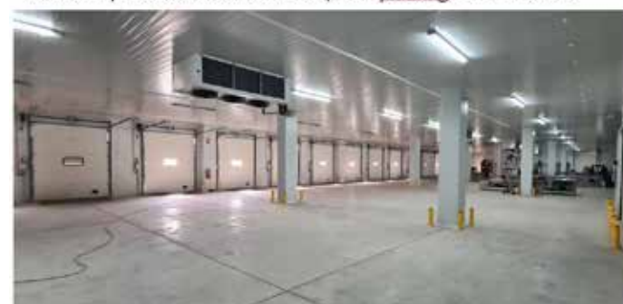
15 muelles abrigados temperatura + 2 de tráiler
